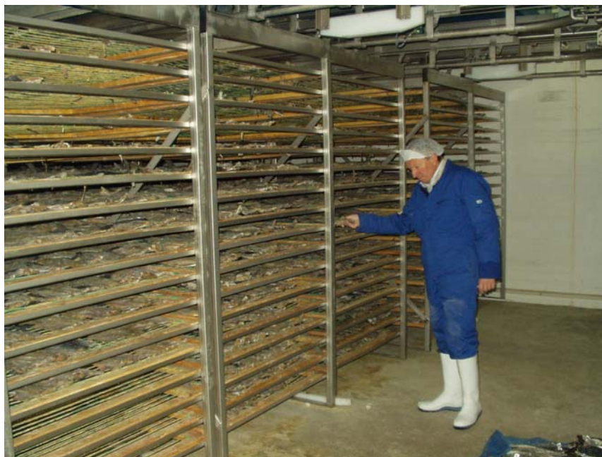
Figur 1. Bilde av hengende reoler i den langblåst tørken fra Optimar. Bildet er tatt i våt ende av tunnelen, der hvor våt fisk lastes inn.
