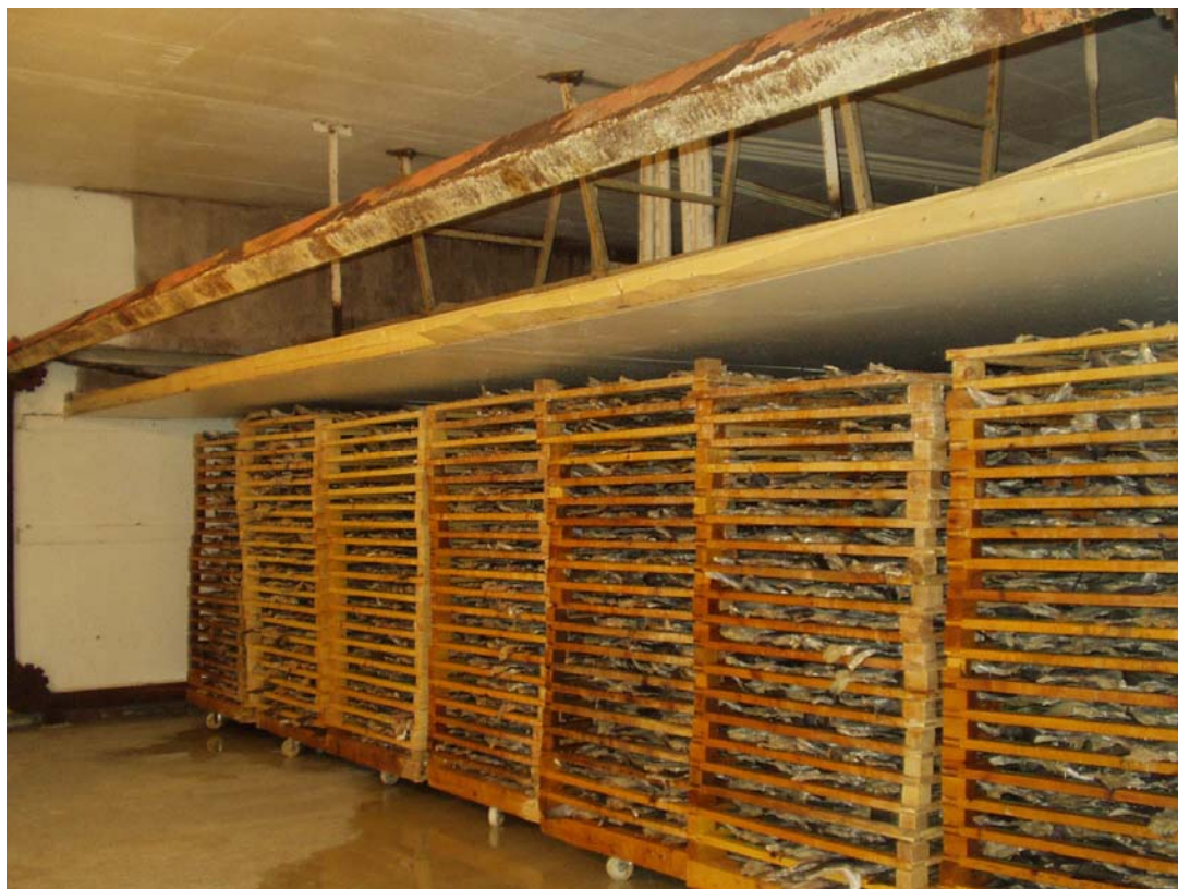
Figur 10. Bilde av tørketunnelen fra A&G, fra våt ende. Det mekaniske arrangementet for fremføring av vognrekkene gjennom tunnelen vises oppe ved tilluftskanalen.
